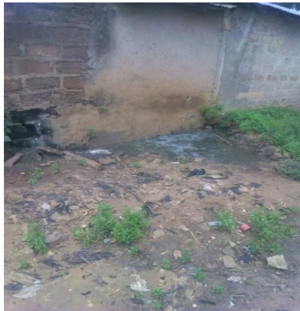
Figure 6. Photographie montrant l'arrière d'une douche sans puisard où l'eau usée d'une couleur verdâtre stagne et rend l'environnement insalubre. Comme conséquence, la prolifération des microbes et en occurrence des vecteurs du paludisme. Prise de vue : Aissi, mars 2023
