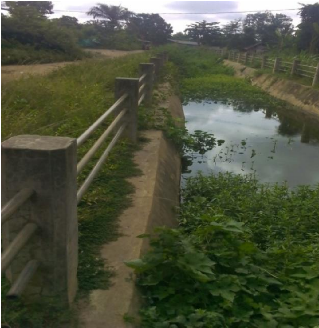
Figure 4. Photographie illustrant l'état insalubre d'un collecteur d'eau. Prise de vue : Aissi, mars 2023
